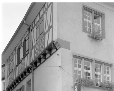
Elévation latérale sur l'impasse des Tailleurs, deuxième étage en pan-de-bois. Phot. Claude Menninger IVR42_19936701672V
